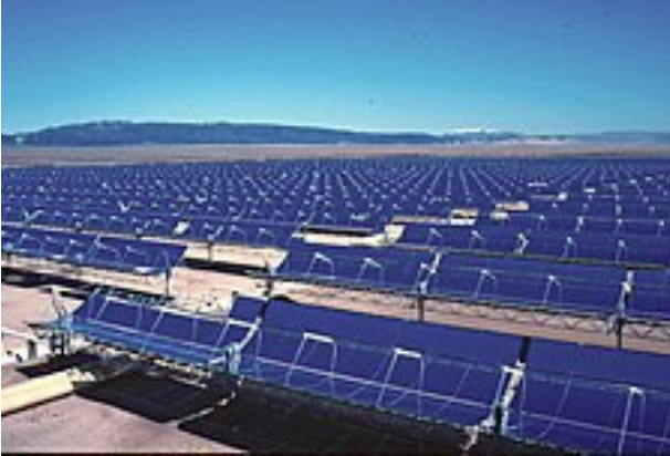
Частина сонячного комплексу SEGS потужністю 354 МВт на півночі округу Сан -Бернардіно, Каліфорнія
