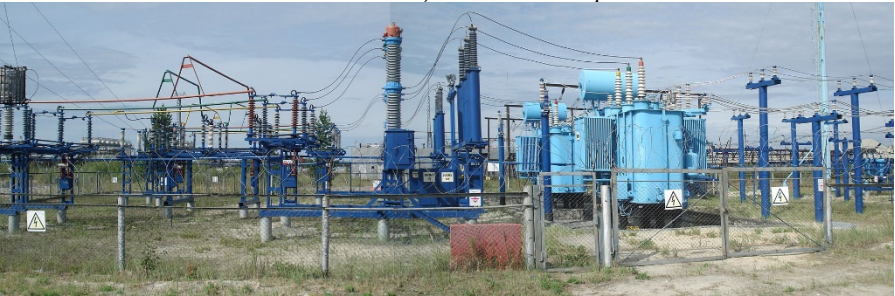
Підстанція в Росії
