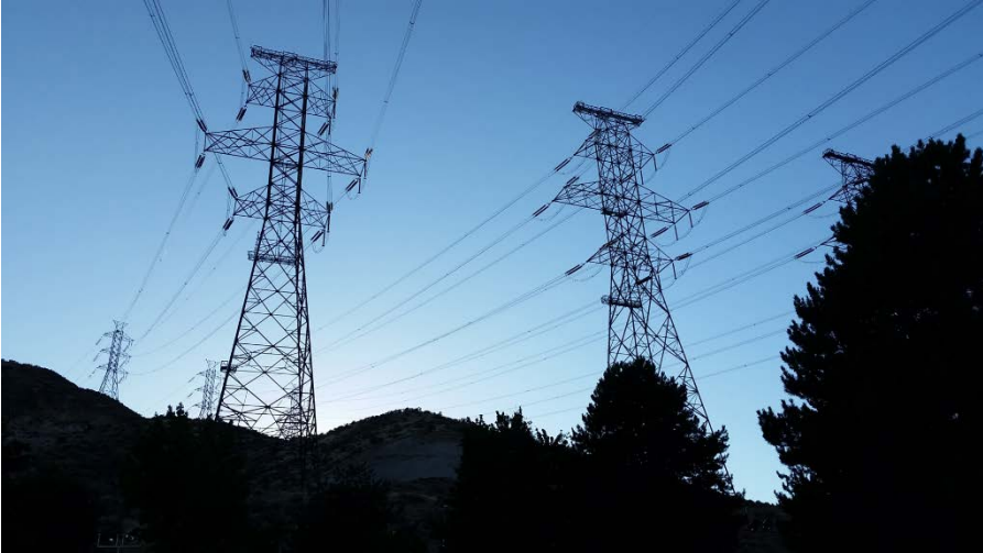
Трифазні лінії передачі електроенергії 500 кВ на греблі Гранд-Кулі
