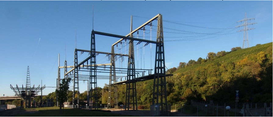
Колишня високовольтна підстанція в Штутгарті, Німеччина, тепер комутаційна станція 110 кВ. Рівень 220 кВ усувається для спрощення мережі.
