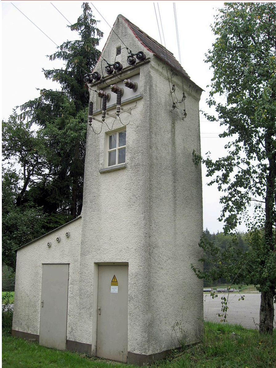
Трансформаторна вежа в Німеччині. Живлення середньої напруги спереду, вихід низької напруги збоку.
