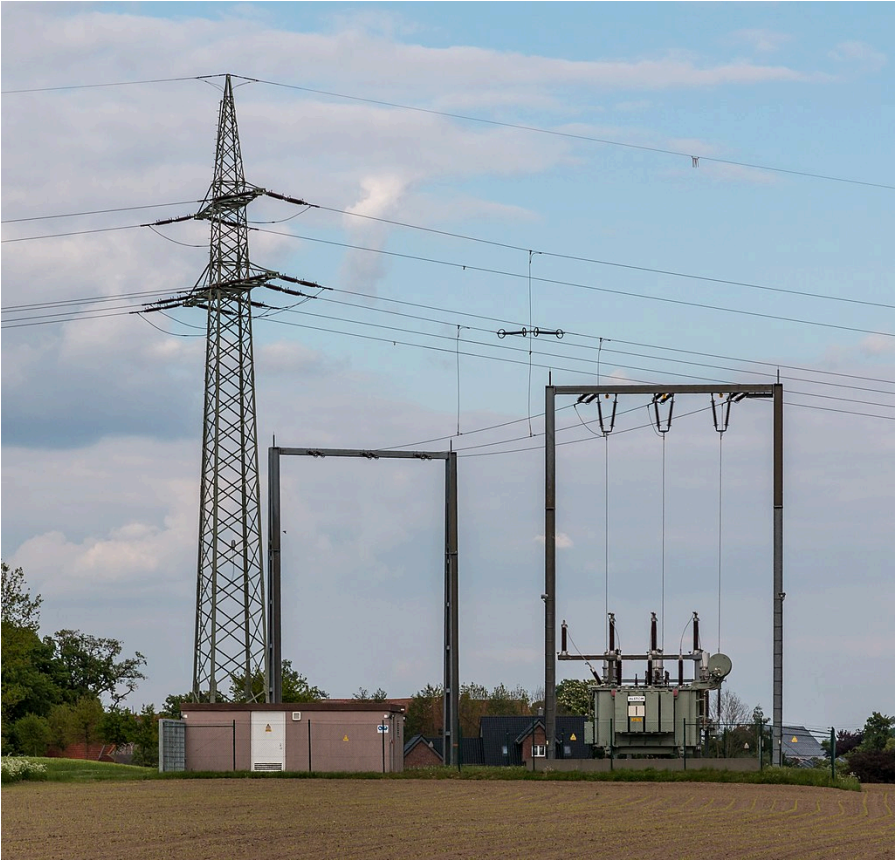
Мінімальна станція HV в Німеччині
